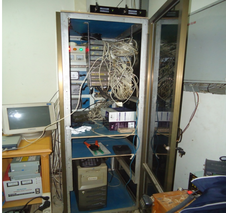
Rak Hub/Switch Yang Ada Pada Ruang Server Kantor Harian Serambi Indonesia
