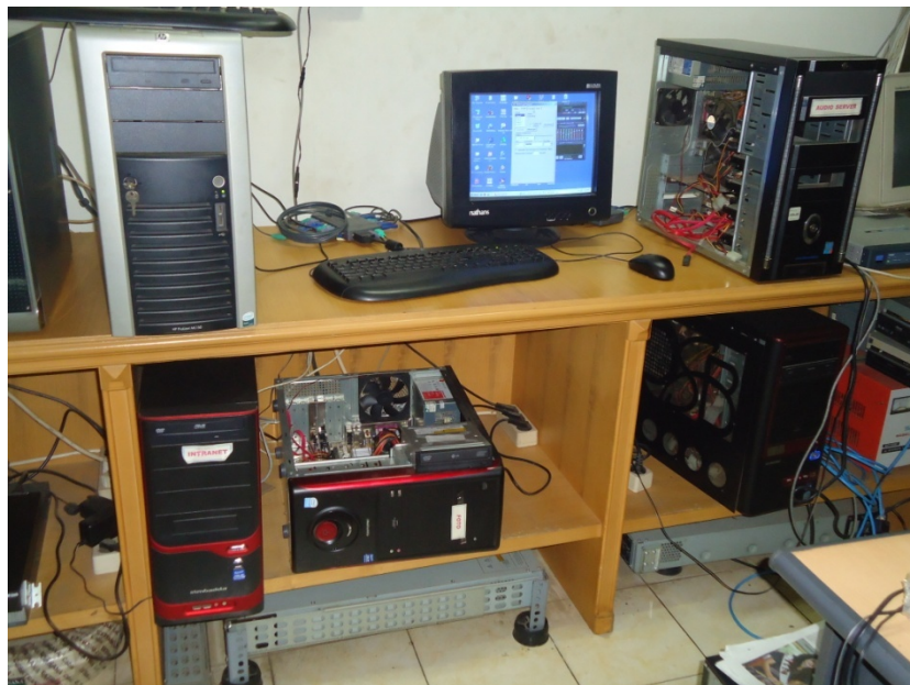
Komputer Server Yang Ada Pada Ruang Server Kantor Harian Serambi Indonesia
